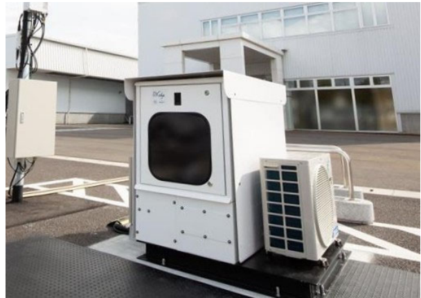
屋外設置タイプ「DX edge Hut」
